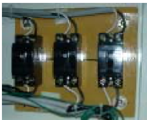
P Cボックス内の漏電ブレーカ
